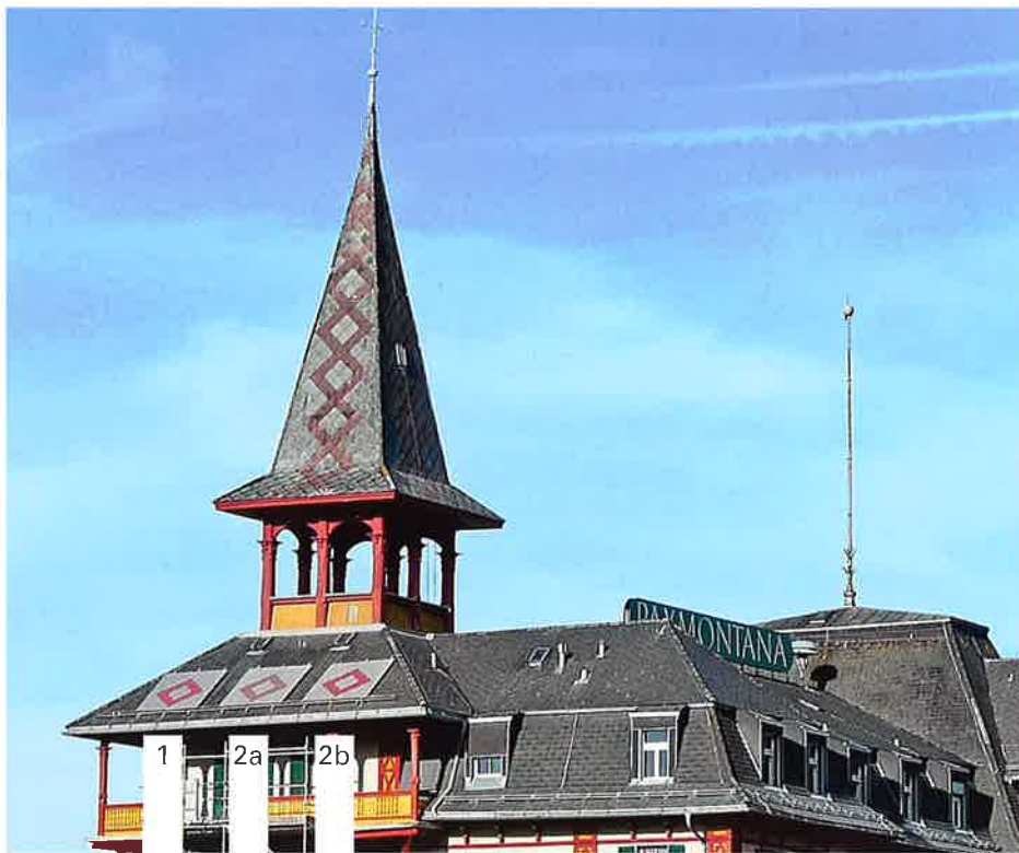
Dachpartien mit Musterplatten vor der Restaurierung.
