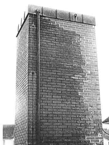
Schäden am Kamin
