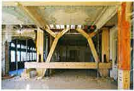
Sachseln: Hotel Paxmontana Abb. 5 Umfangreiche statische Massnahmen machen den fünfgeschossigen Holzbau erd- bebensicher.
