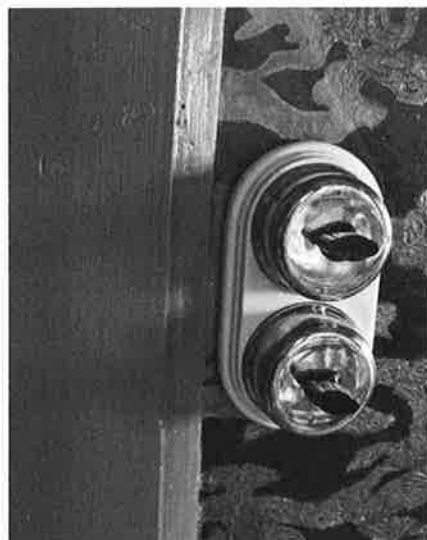
Neue Elektroschalter in Messing Nouveaux interrupteurs en laiton
